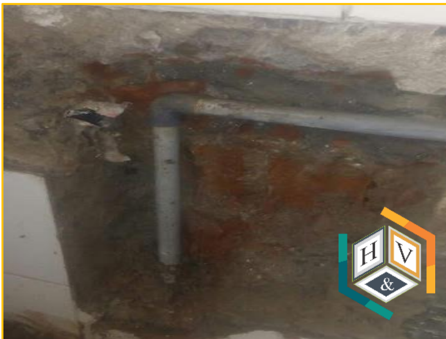
❖ Foto 02: hallazgo de la fuga del agua.
